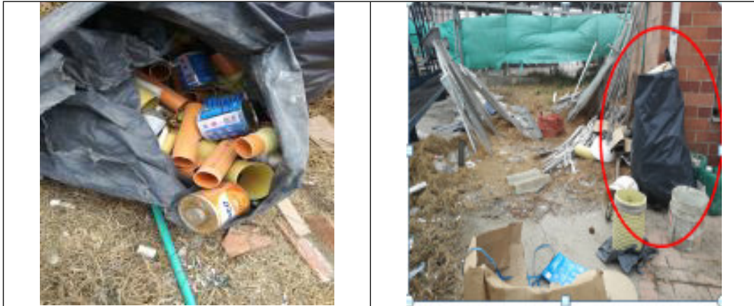
Fotografía 15 y 16. Almacenamiento de Residuos Peligrosos a la Intemperie.
