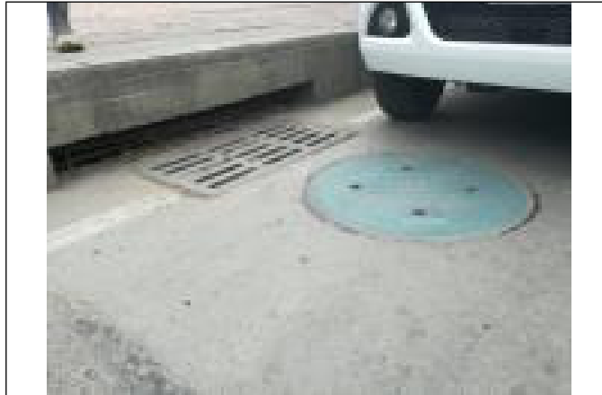
Fotografía 10. Sumidero ubicado en las coordenadas X: 91459.98 Y: 105395.08 sin protección
