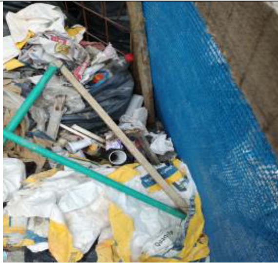
Fotografía 18. Residuos sin la clasificación adecuada.
