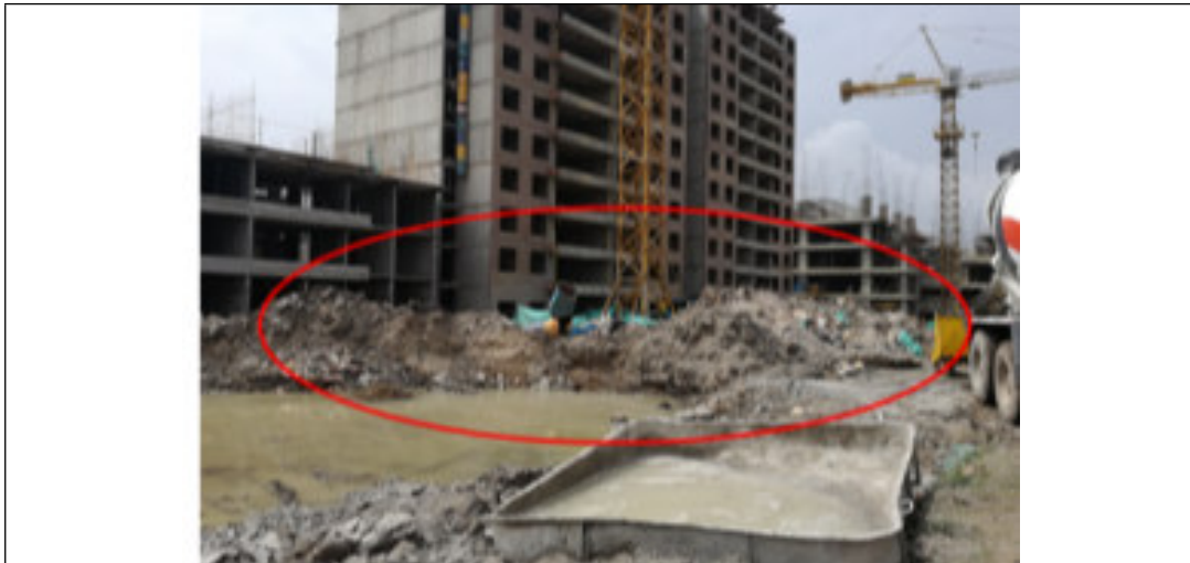
Fotografía 17. Acopio de Residuos de Construcción y Demolición sin la protección correspondiente.
